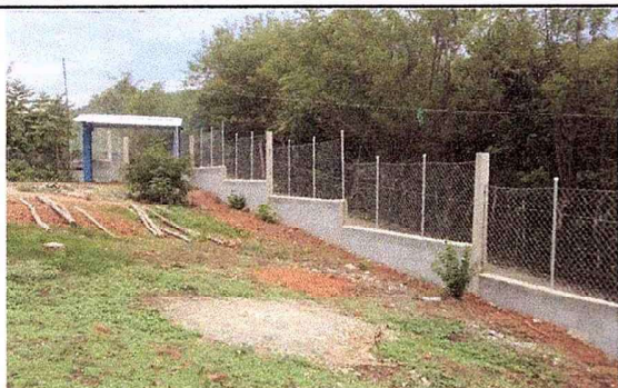
Foto1: de esta forma se encuentra el muro perimetral gracias al programa de mantenimientos de edificios escolares
